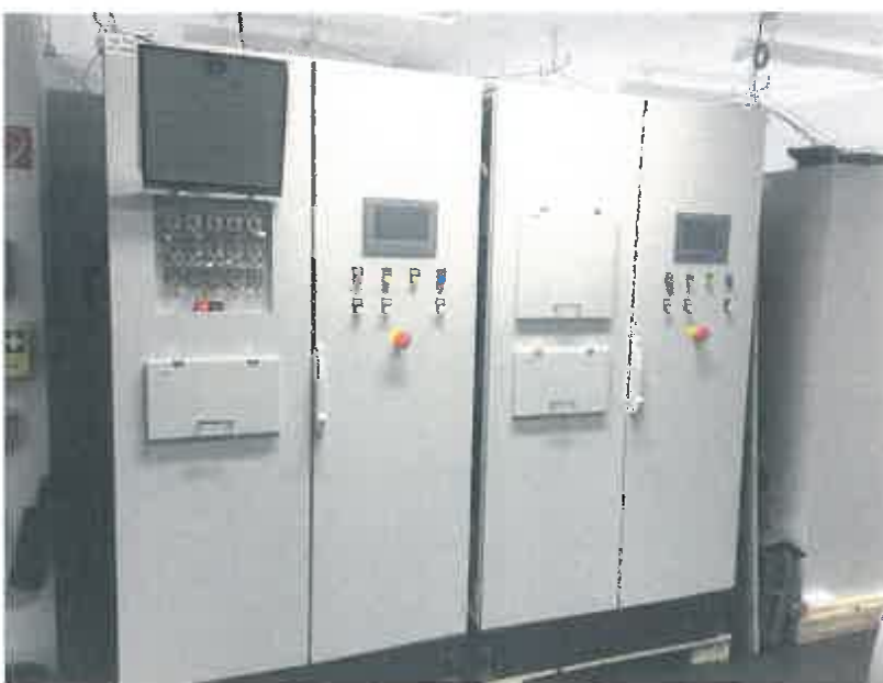
Bild 8: Steuerschrank für die Leittechnik in der Fertigung, links Schlüsselschalter für 15 Mitarbeiter (Foto: RPS).
